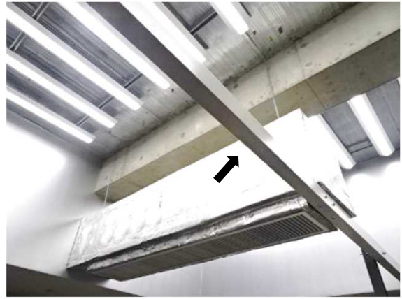
照明器具と耐震フレーム
